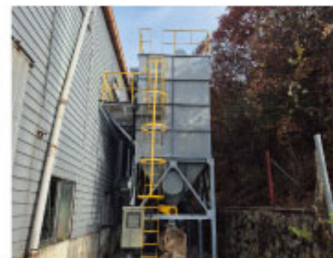
집진기 및 전기판넬 설비 사진
